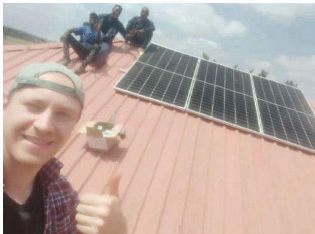
Abb1: Aufbau Solarplatten auf Gebäuden in Kenia.
