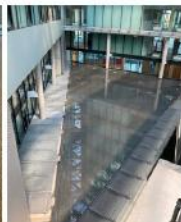
Techbrecken / Wasserveranlage (außen/innen)
