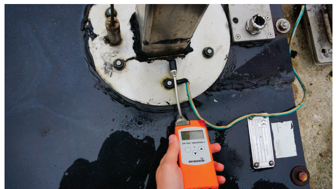
Detektion einer Gasleckage mittels Methanschnüffler an einer Überdrucksicherung
