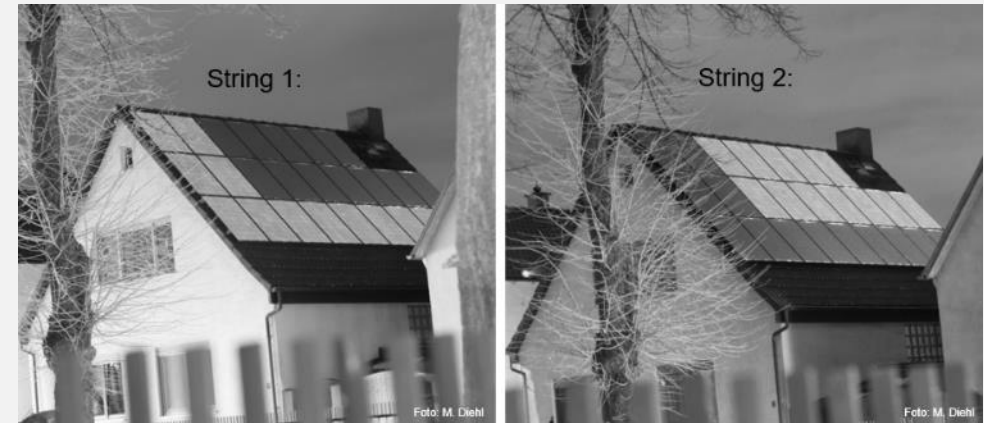
Bestromung von Strings bei Nacht (EL-Technik)
