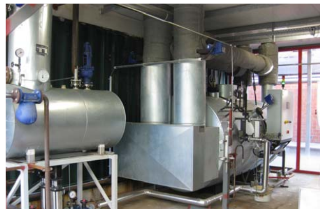
Speisewasserkessel (l.) und Dampferzeuger (r.)
