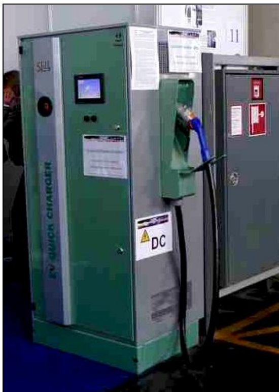
Abb. 3-9: Chademo Schnellladestation 500 V Gleichstrom [18]
