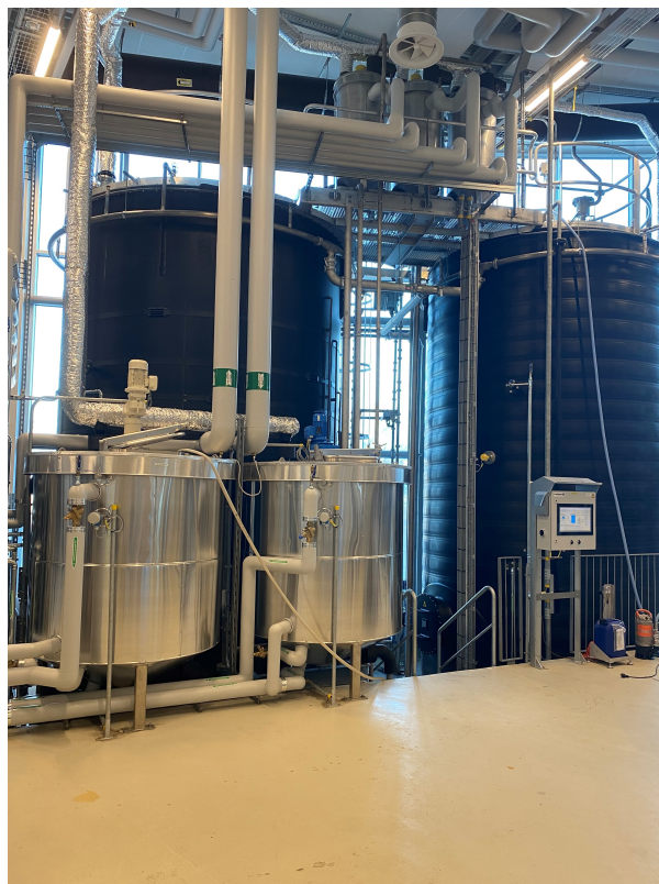
Abb. 1: UASB-Reaktoren in Helsingborg (Foto: Hamse Kjerstadius)
