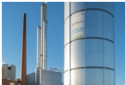
Abb. 1: Wärmespeicher des Unternehmens N-ERGIE (Bildquelle: N-ERGIE).
