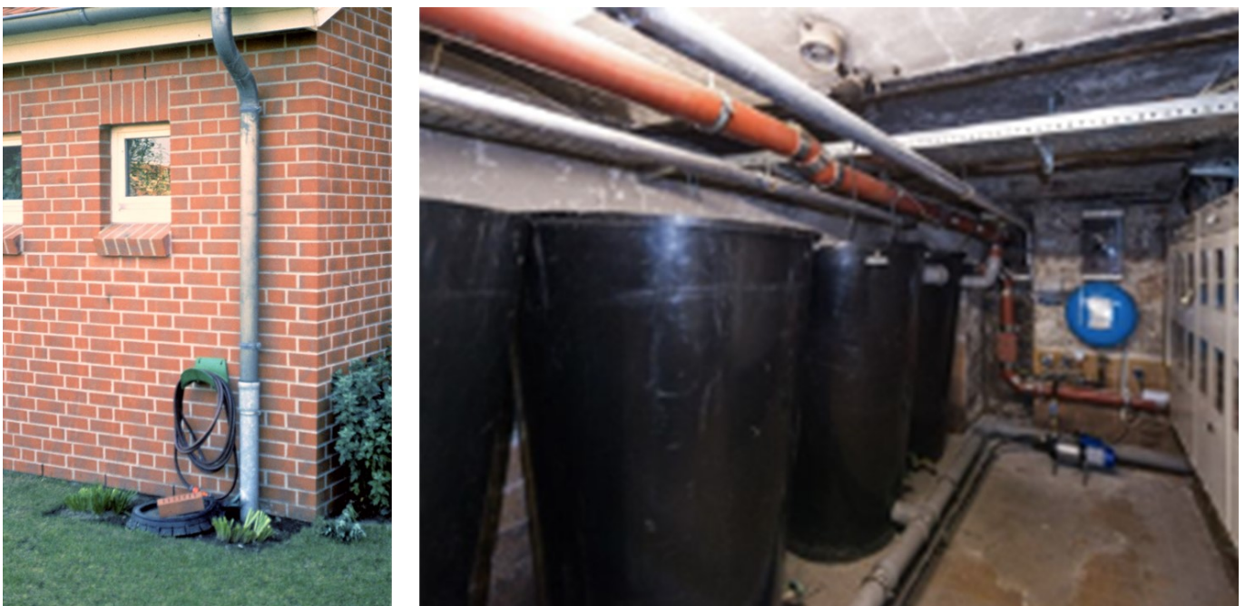
Abb. 1: Regenwassernutzung Hausinstallation (Bildquelle: Mathias Uhl)
