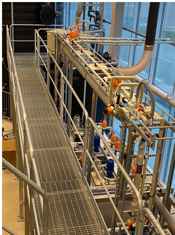
Abb. 1: Draufsicht auf eine Anlage zur Struvitfällung in Helsingborg (Foto: Hamse Kjerstadius)
