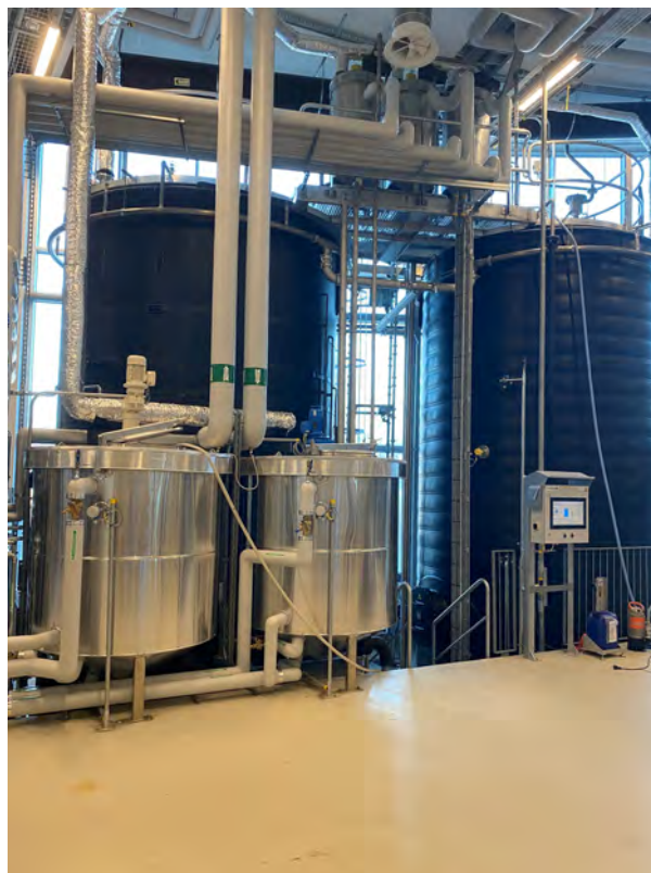
Abb. 1: UASB-Reaktoren in Helsingborg (Foto: Hamse Kjerstadius)
