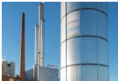
Abb. 1: Wärmespeicher des Unternehmens N-ERGIE (Bildquelle: N-ERGIE).
