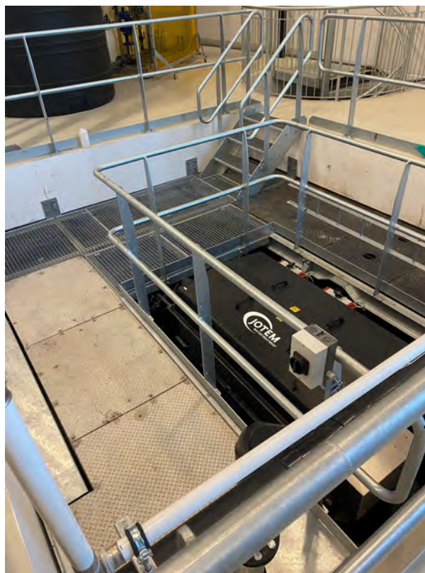
Abb. 1: Draufsicht auf eine Grauwasser-Behandlungsanlage in Helsingborg (Foto: Hamse Kjerstadius)
