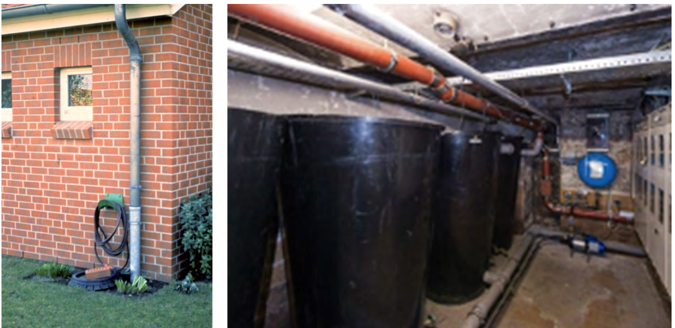
Abb. 1: Regenwassernutzung Hausinstallation (Bildquelle: Mathias Uhl)
