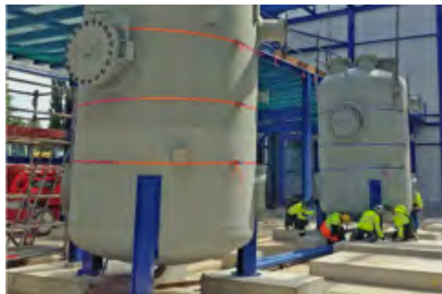
Abb. 1: Elektrodenheizkessel (22 m 3 ) von Vattenfall in einer PtH-Anlage in Berlin (Bildquelle: Vattenfall).
