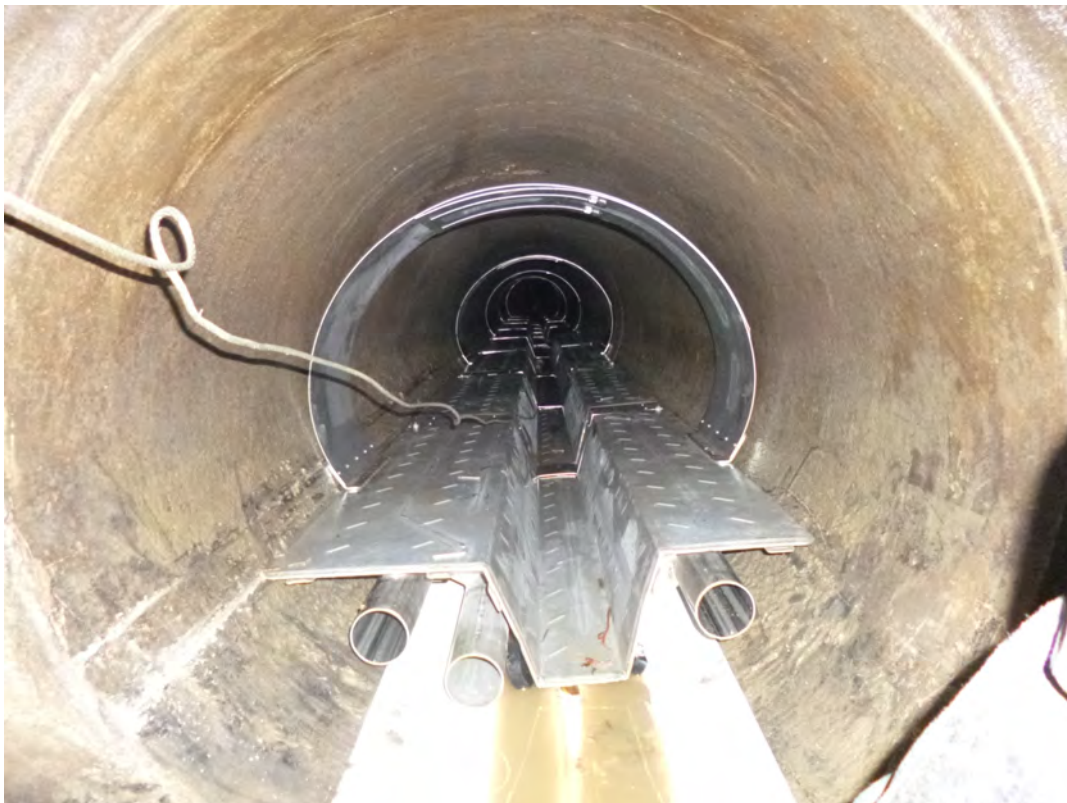
Abb. 1: Anlage zur Wärmerückgewinnung im Kanalsystem (Klinger und Partner GmbH, Stuttgart)
