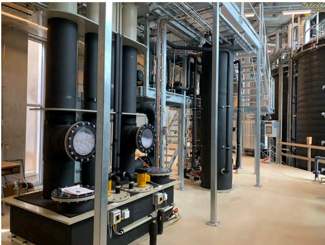
Abb. 1: Ammoniumstrippung mit saurer Wäsche in Helsingborg (Foto: Hamse Kjerstadius)
