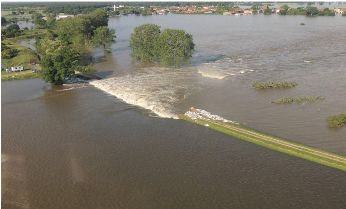
Bruch des rechten Elb-Hauptdeiches bei Fischbeck in Sachsen-Anhalt im Juni 2013 (Foto: Jüpner)
