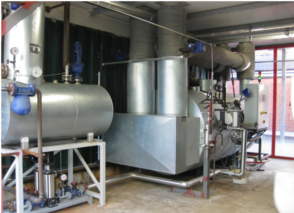
Abb. 8-6: Abhitzedampferzeuger einer dezentralen Brennerei
