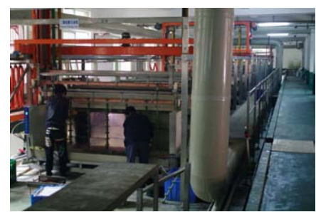
Anlage zur Elektroplattierung
