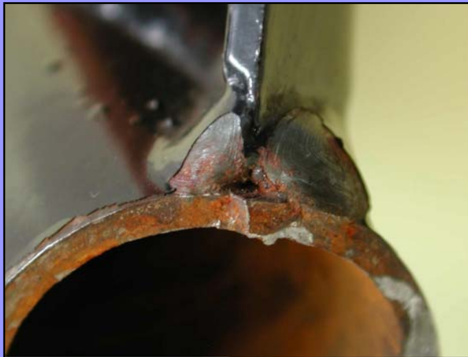
Dauerbruch ausgehend von Schweißnahtkerbe (Geschweißte Rahmenkonstruktion)
